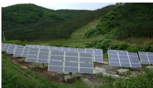
徽州 4 号隧道太阳能供电
