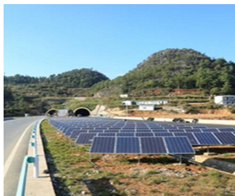
隧道采用太阳能供电技术
